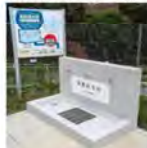
応急給水施設の整備
