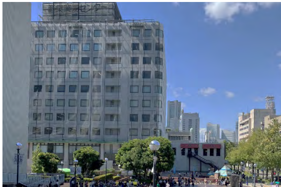
老朽化した施設
