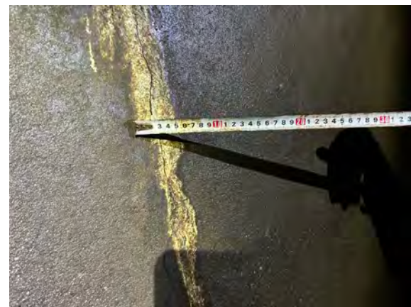
下水道管内の状況(クラックの一例)
