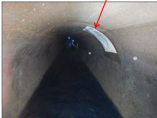
部分修繕の例
