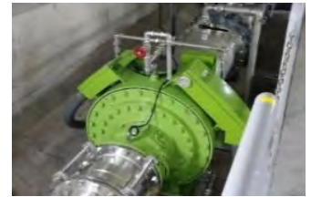
小水力発電設備
