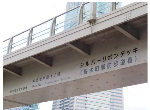
【ネーミングライツ事業】 シルバーリボンデッキ(桜木町駅前歩道橋)
