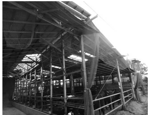
畜舎の屋根の破損
