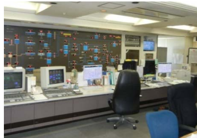
浄水場計装設備
