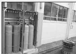
LP ガスボンベ庫
