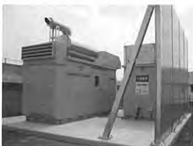
非常用自家発電設備 (磯子配水池)
