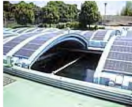
写真7 小雀浄水場の太陽光発電設備
