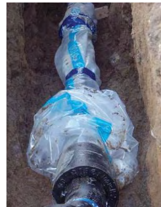
ダクタイル鋳鉄管(DIP) ポリエチレンスリーブ有
