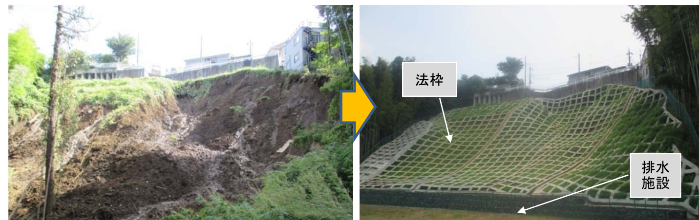
崖崩れ直後：平成 26 年 10 月 7 日撮影
