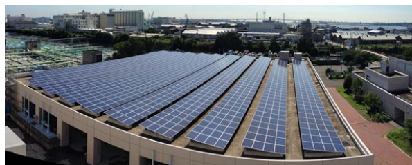
〈太陽光パネル(神奈川水再生センター)〉
