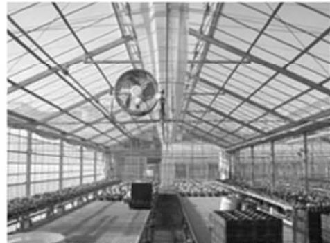
【写真】循環扇を設置した温室
