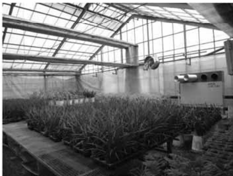
【写真】ヒートポンプを設置した温室
