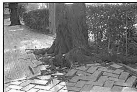
街路樹の根上がりの状況
