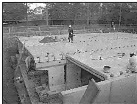
流域貯留施設の施工状況 (写真は平成23年度施工の平戸台小学校)
