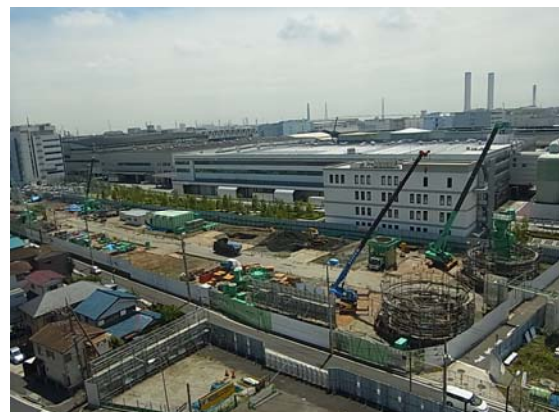
北線及び岸谷生麦線橋梁基礎施工状況 （鶴見区生麦一丁目）
