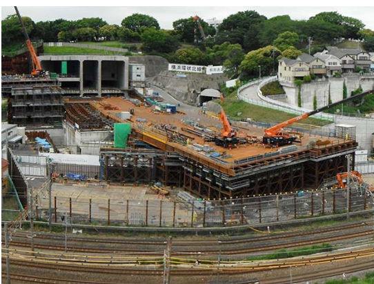
鉄道交差部橋梁架設のための作業構台施工状況 （神奈川区子安台一丁目）
