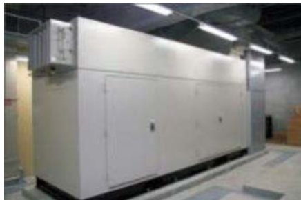
自家発電設備
