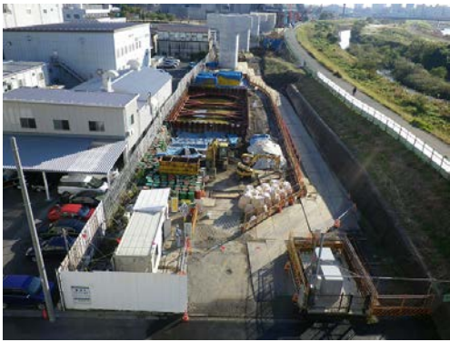
写真1 有害物質検出箇所全景
