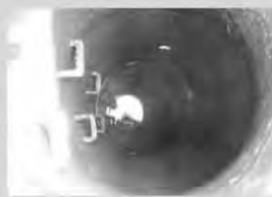
マンホール内の滞水状況
