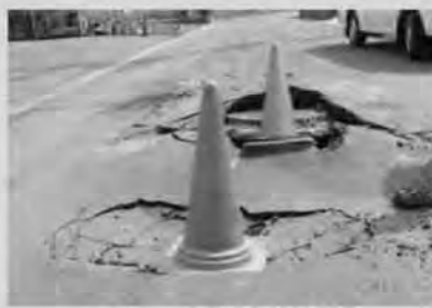
マンホールの突出と道路陥没
