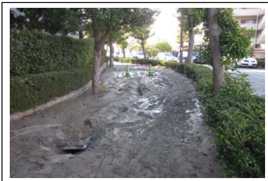
【液状化：金沢区柴町】
