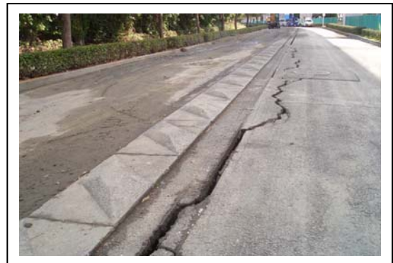
【路面損傷：金沢区福浦三丁目】
