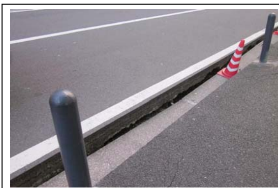
【路面陥没：中区翁町 2 丁目】
