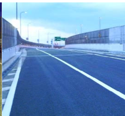
現在の路面状況
