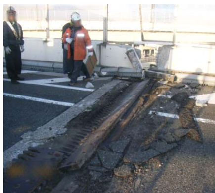
震災による路面損傷状況
