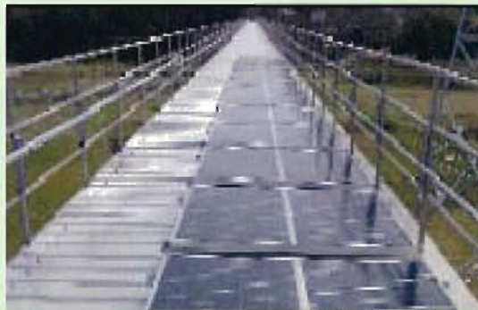
引地川水路橋の太陽光発電設備
