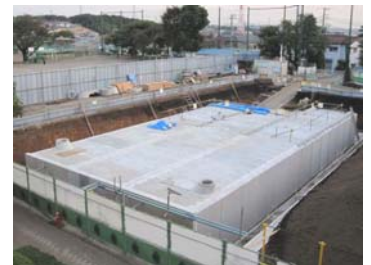
②-5 流域対策 東中田小学校(地下式貯留:泉区)
