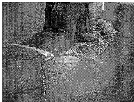
根上がりにより凹凸が生じている歩道 (泉区・いずみ野駅前)
