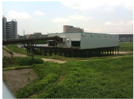
④トンネル工事で発生した土の 仮置きヤード（鶴見川遊水地内）
