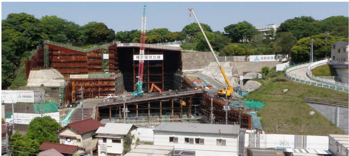
⑤JR 京浜東北線側から見た子安台換気所全景 （神奈川県子安台公園）
