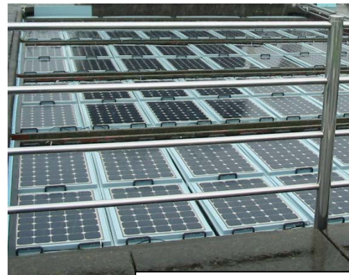
小雀浄水場2系沈でん池 フロート式太陽光発電設備
