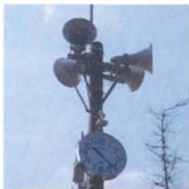
岸谷地区の防災スピーカー
