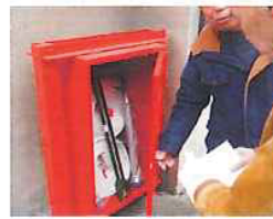
■ 消火箱についての説明を受ける。
