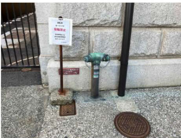
写真 3-35 建物北西隅部 スプリンクラー専用送水口 及び 駐輪禁止看板
