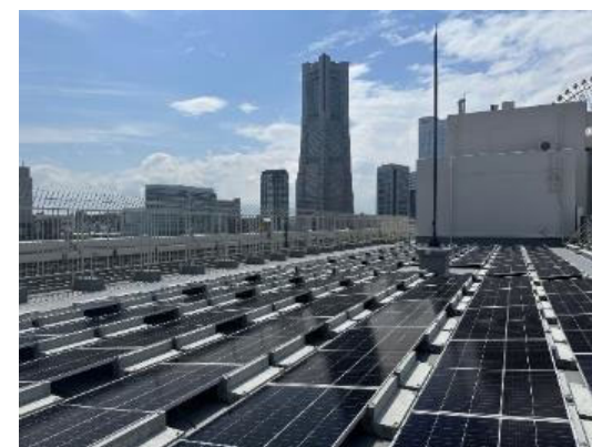
太陽光発電設備の積極的な設置
