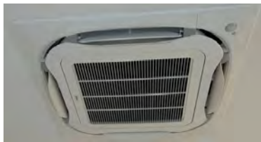
業務用空調設備
