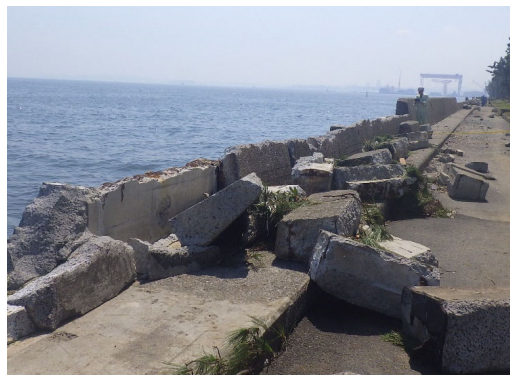
インフラ損傷
