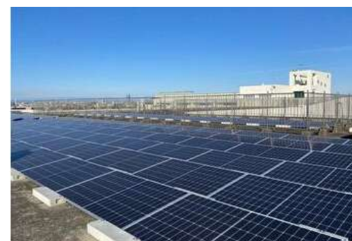
太陽光発電設備
