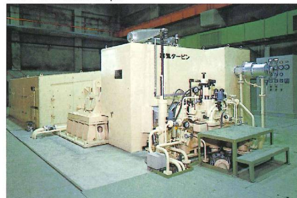
蒸気タービン発電機/Steam turbine generator
