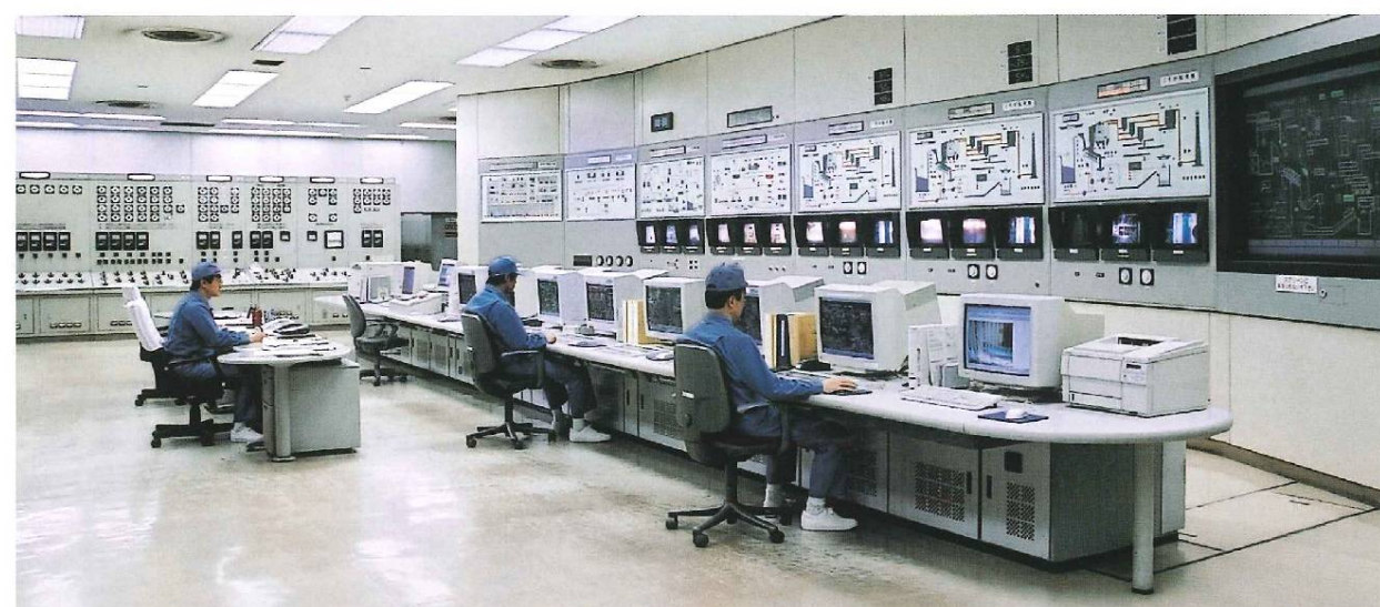
中央管制室/Central control room
