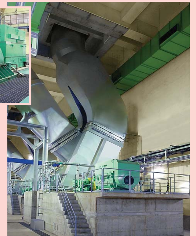
誘引通風機 Induced draft fan
