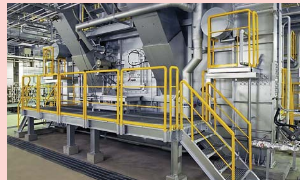
焼却炉本体 Incinerator
