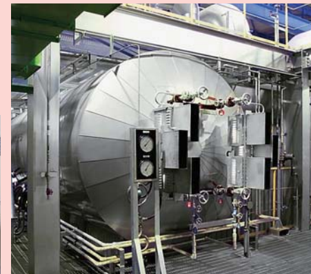
ボイラドラム Boiler drum
