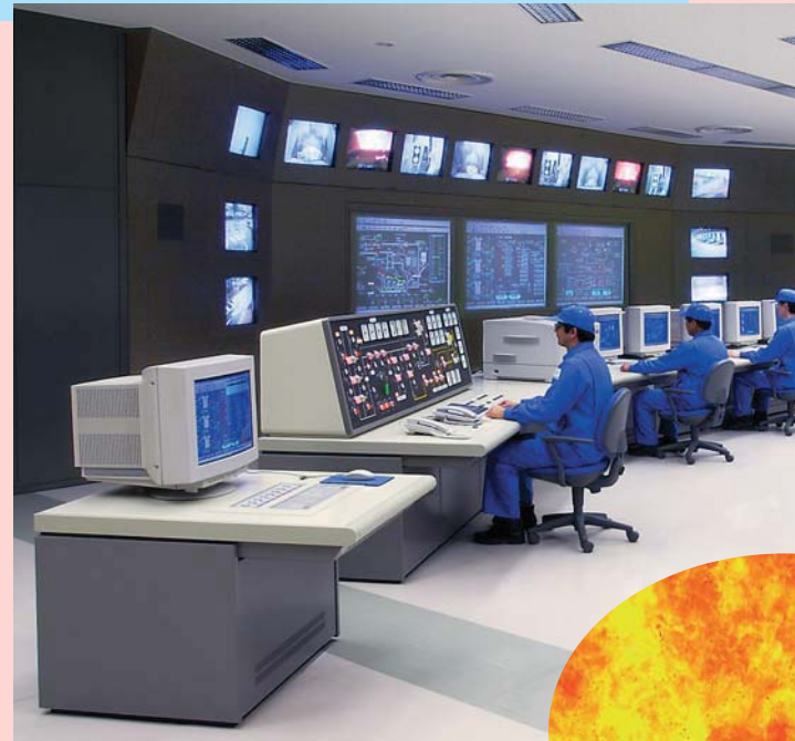
中央管制室 Central control room
