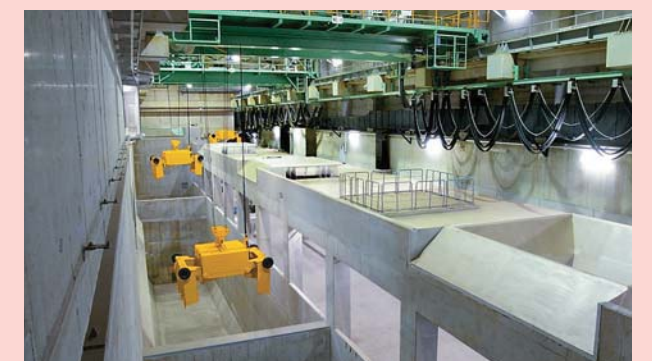
灰ピット／灰クレーン Ash pit & ash crane
