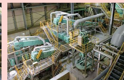
焼却灰搬送コンベア Incineration ash conveyor
