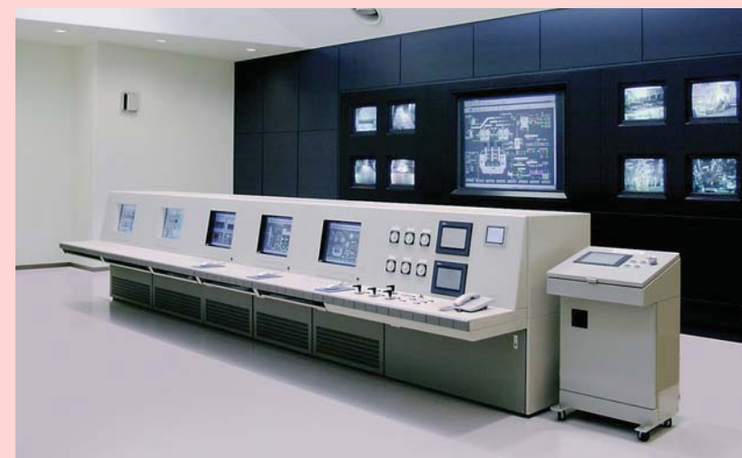
管制室 Control room
