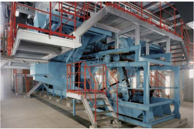
灰押し出し装置・灰搬出装置
