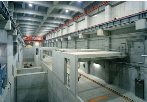
灰ピット・灰クレーン
