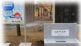
災害時給水所（耐震給水栓）
