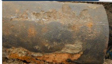
老朽化により劣化した管路
