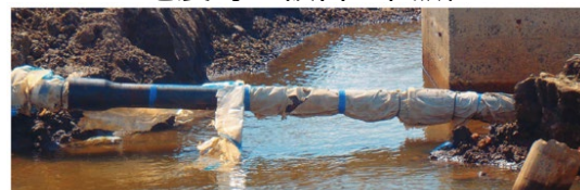
▲東日本大震災の津波にも耐えた耐震管（平成23年 仙台市水道局提供）
