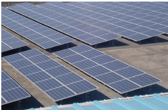
太陽光発電設備(川井浄水場)
