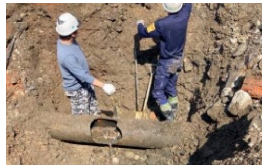
鋳鉄管の破損事故
