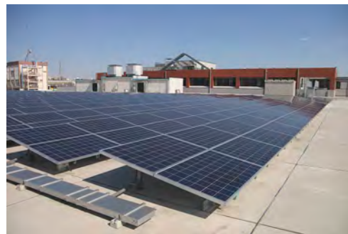
太陽光発電(川井浄水場)
