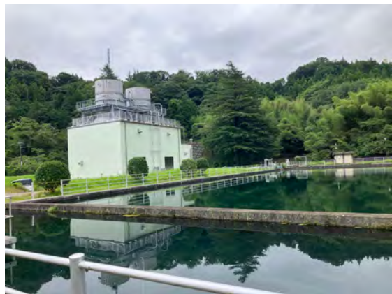
青山沈でん池 活性炭注入設備
