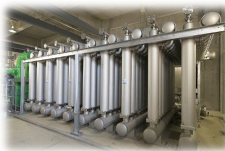
再整備後の川井浄水場 (膜処理装置(セラロックス))
