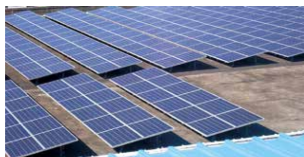
太陽光発電設備(川井浄水場)
