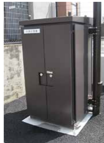
水道計測設備
