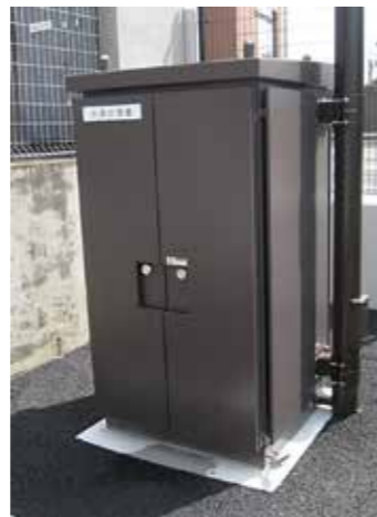
水道計測設備
