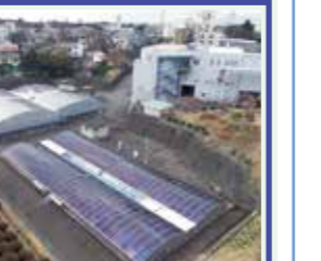
排水処理施設
