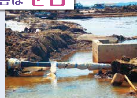
▲東日本大震災の津波にも耐えた耐震管(仙台市水道局提供)
