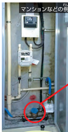
水道メーター
