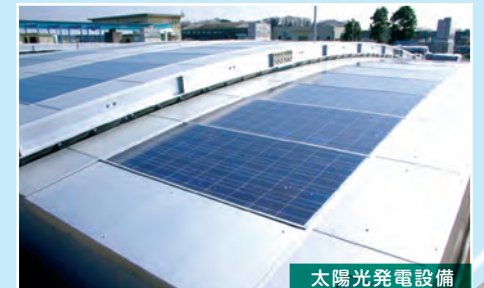
太陽光発電設備
