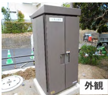
水道計測設備の写真
