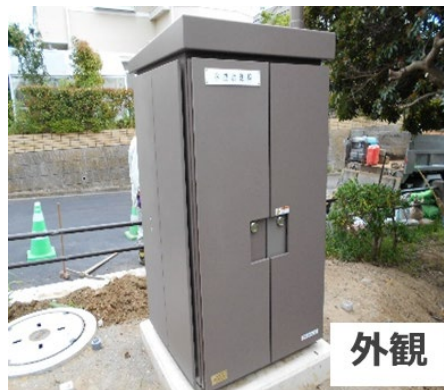
水道計測設備の写真
