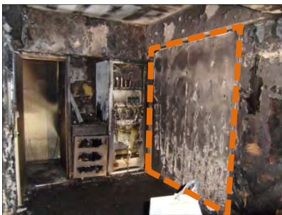
火災発生現場
