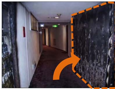
防火戸を開けた状態 ※点線部=防火戸
