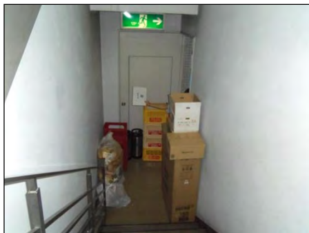
避難口及び防火戸前に物件が置かれている様子
