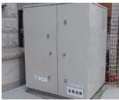
集合住宅用変圧器
