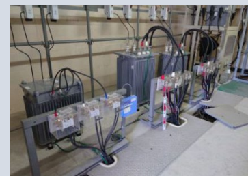
▲ 電気室内の様子
