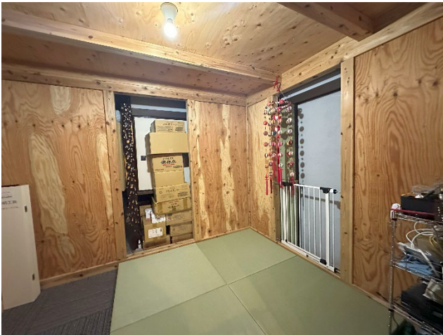
▲耐震シェルター内部の様子
